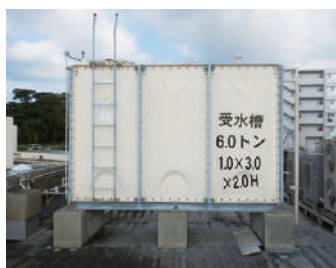
■水タンクの設置状況
