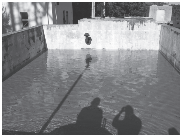
写真7. 遮光ネット設置前のB浄水場ろ過池
