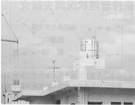
ステンレス製水タンクの設置例
