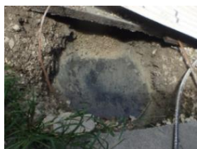
図 4 排水管が壊れてできた汚水溜まり
