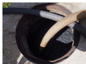
図 3 蓋の無い貯留槽
