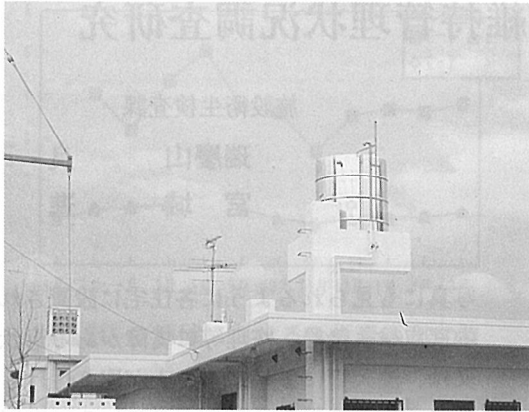
ステンレス製水タンクの設置例
